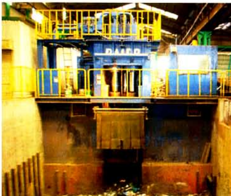
大同機器が10年9月に納入した「メンテ・フリー」の1,000トキロチン。「これからは故障とランニングコスト(維持・補修費)に強い機械が必要だ」との信念から開発された(軽量・長尺専用機)。
